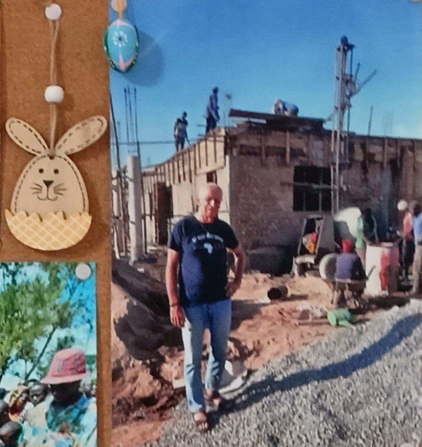
P. Stanislaus machte sich selbst ein Bild vom Wasserfall mit seiner Niederlassung in Gulu. Der Bau geht wirklich gut voran und bis Weihnachten soll das Dach auf dem Rohbau fertig geschlossen sein.
